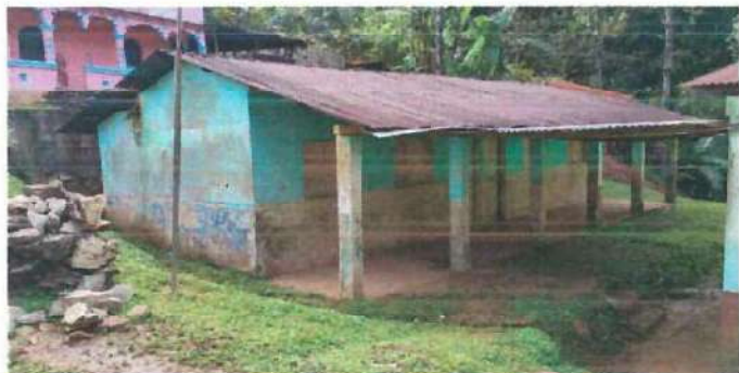
Foto 1 se necesita cambiar la cubierta de lamina, modulo 1
